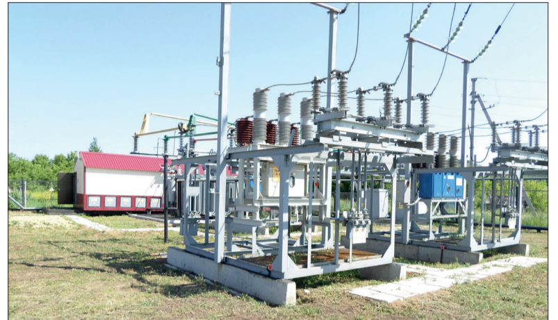
Подстанция № 123 НГДУ «Ленингорскнефть» после реконструкции
