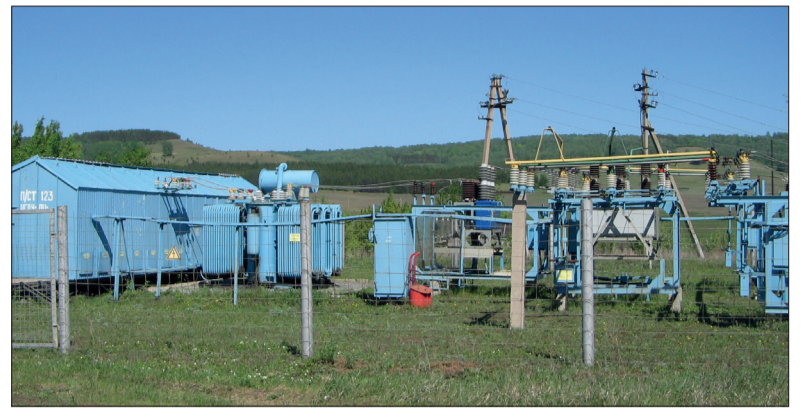
Подстанция № 123 НГДУ «Ленингорскнефть» до реконструкции
